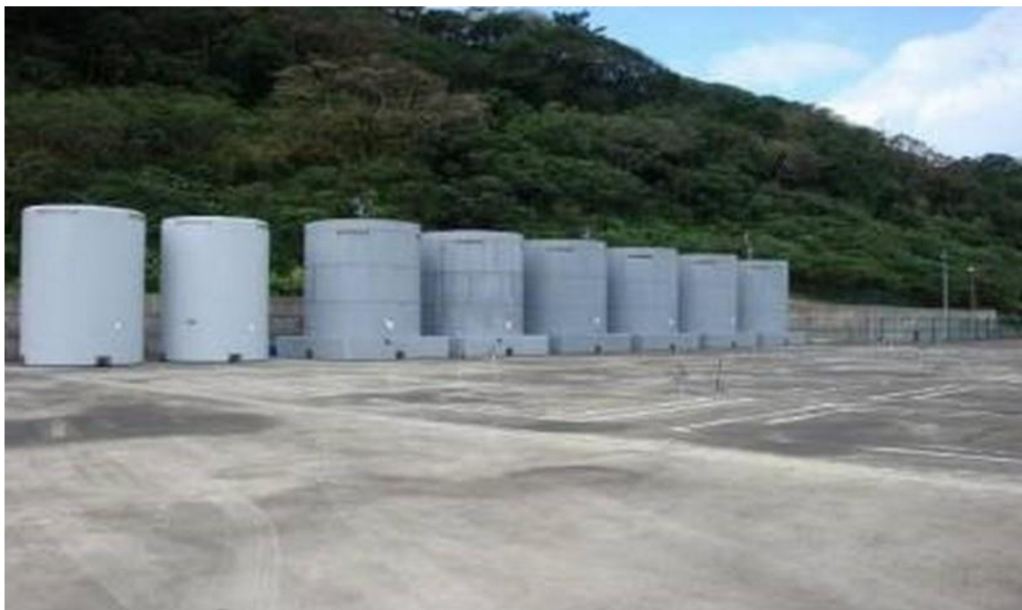
核一廠一期乾貯採露天設計。（台電提供）
