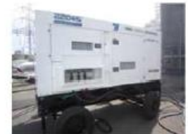
可攜式直流電源設備
